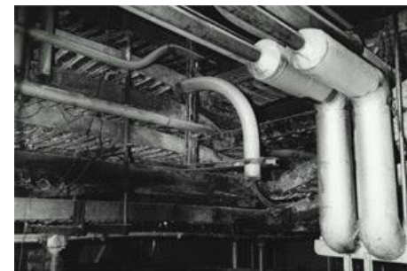
Incendie de la centrale de Browns-Ferry
