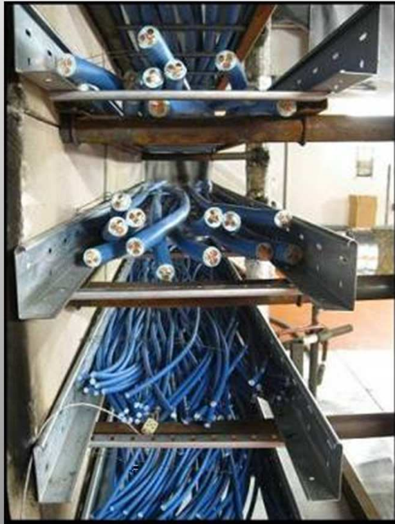
D1 and D2 cables
