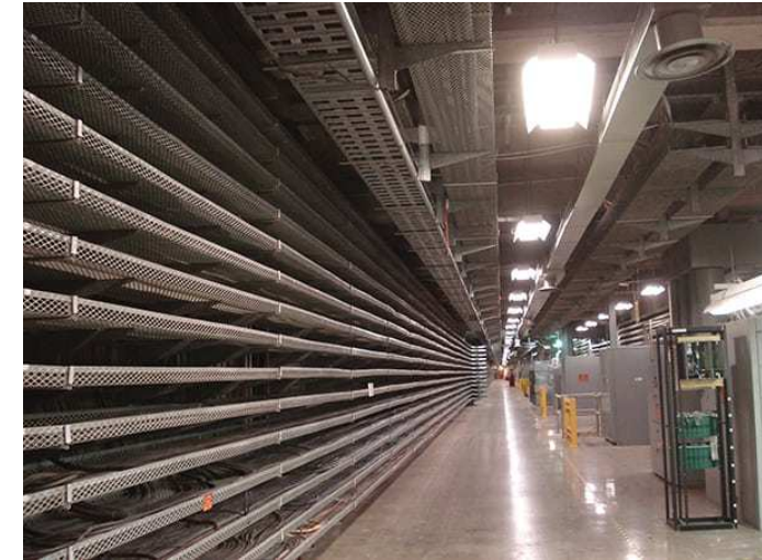
Chemins de câbles électriques dans une installation nucléaire
